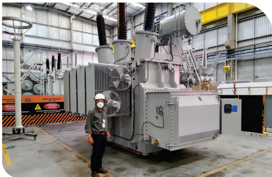
A subestação contará com novos equipamentos de alta tensão, como esse transformador
